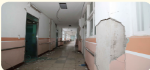
건물 내부 벽체 파손
