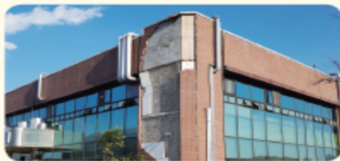
건물 외벽 탈락
