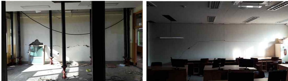
[해그림 6-7] 조적채움벽의 수평줄눈균열 (홍해초등학교, 2017 포항지진)
