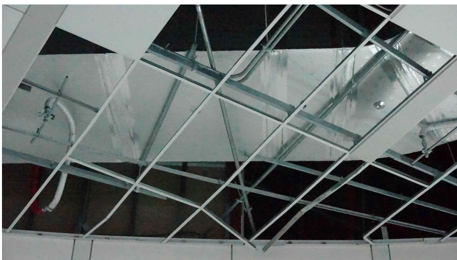
[해그림 17-3] 프레임의 변형 및 패널이 탈락된 대공간 천장 (2017. 포항지진)
