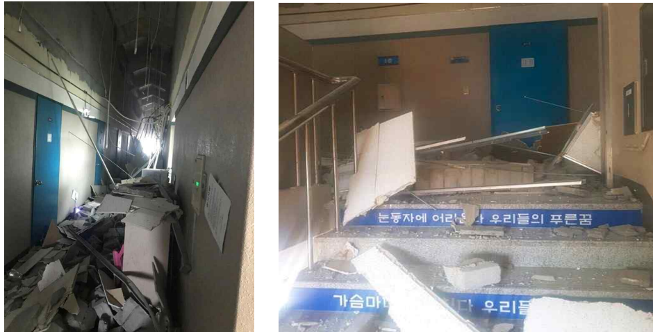
[해그림 17-4] 천장 탈락에 의한 복도 및 계단실 피난경로 피해 사례 (2017. 포항지진)
